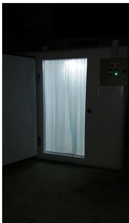
Figura 3.1: Instalación frigorífica de almacenamiento de helados.
