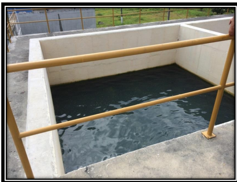
Figura 4.11 Filtro de 100 L/s de la planta de potabilización.
