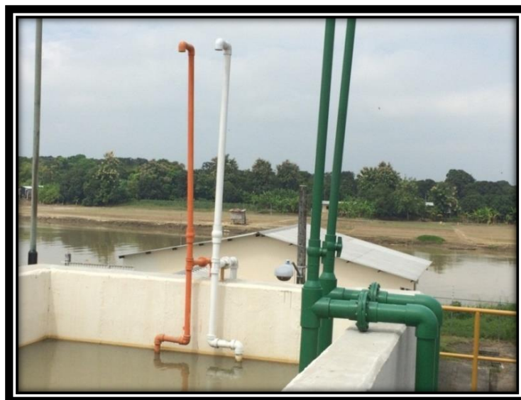
Figura 4.6 Antigua ubicación de colocación de cloro y polímero.
