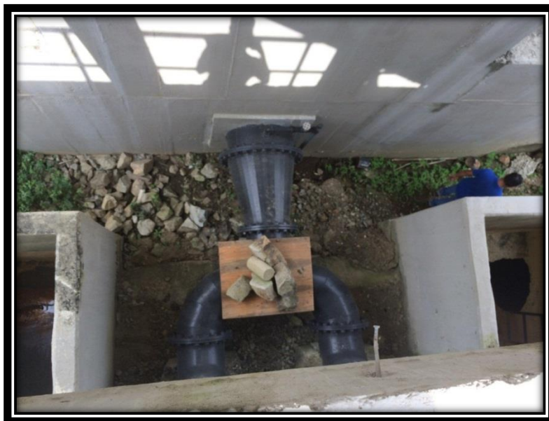
Figura 4.7 Tubería de conducción hacia área de floculación.
