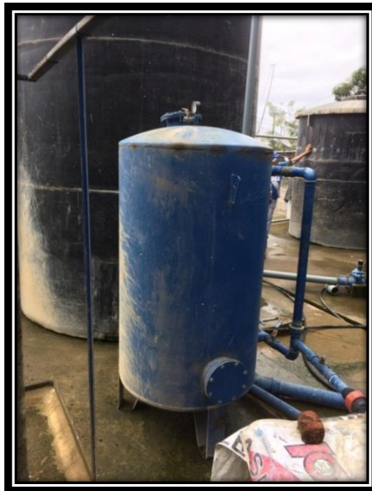
Figura 3.4 Filtro usado en la planta de Limonal
