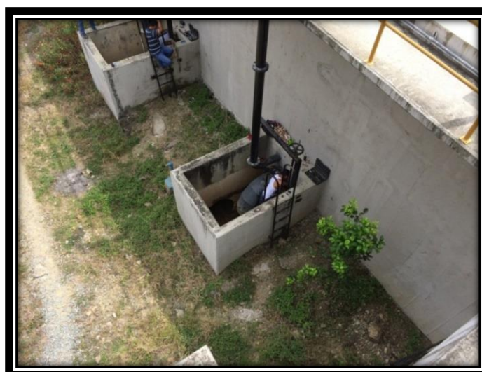
Figura 4.9 Tubería para extracción de lodos acumulados en fase de floculación
