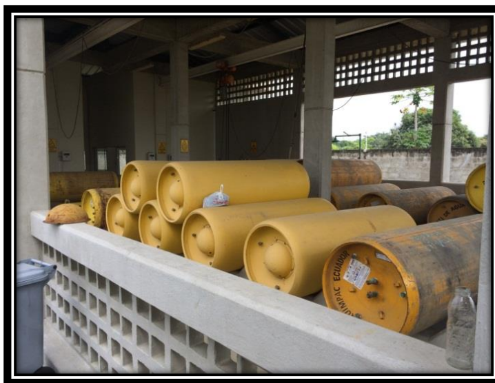
Figura 4.14 Tanques de cloro, para proceso de cloración, en bodega.
