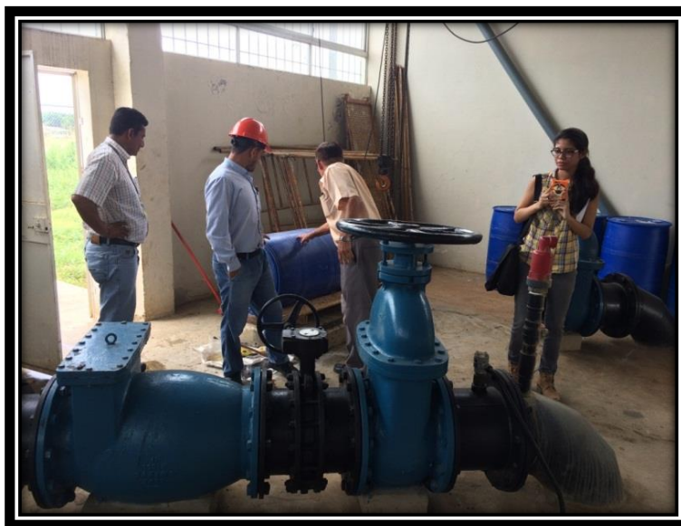
Figura 4.4 Cuarto de bombas de la planta potabilizadora de Daule.
