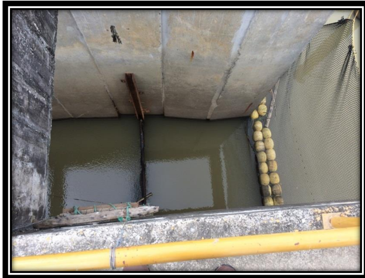
Figura 4.2 Canal de captación del río Daule. Fuente: Briones J., Macías E., 2017
