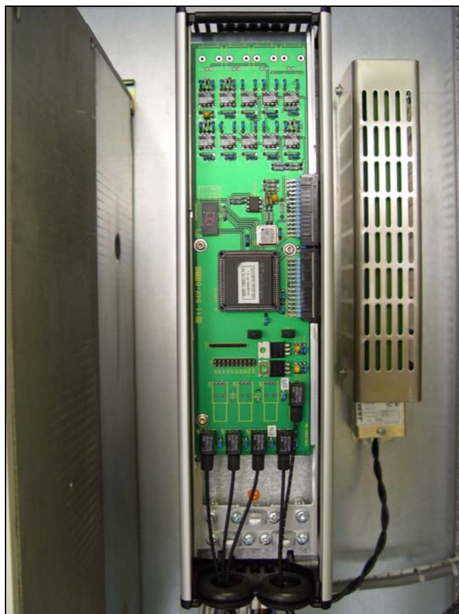
Figura 3.12: Variador de Frecuencia marca Danfoss
