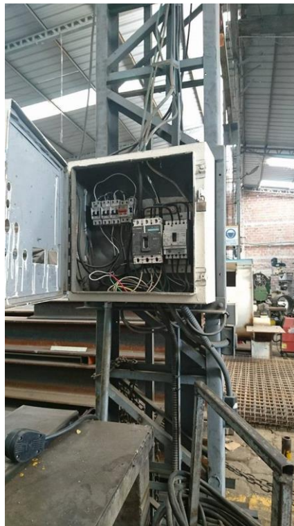
FIGURA 8. INSPECCIÓN DE CONEXIONES ELÉCTRICAS INADECUADAS
