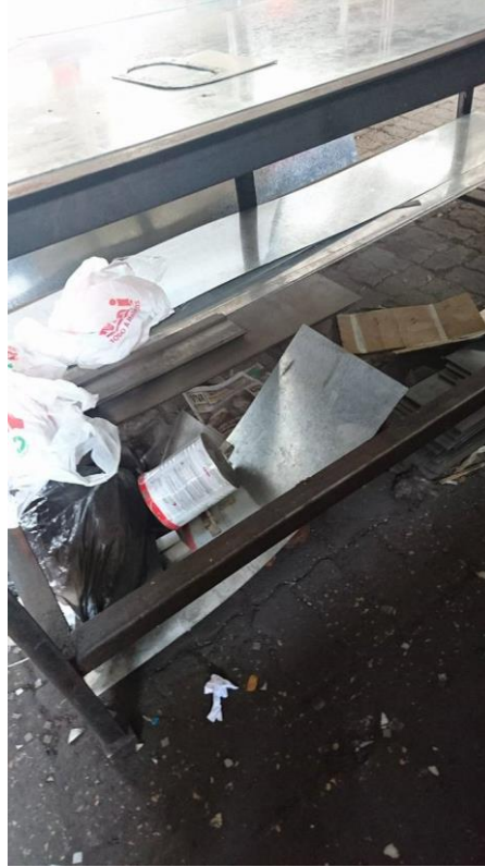
FIGURA 13 INSPECCIÓN DE OBSTÁCULOS EN EL PISO
