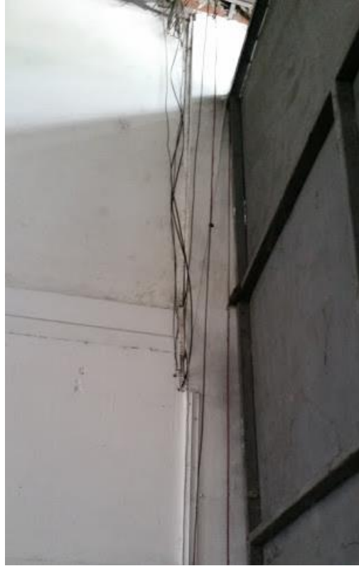
FIGURA 9. INSPECCIÓN DE CONEXIONES ELÉCTRICAS INADECUADAS
