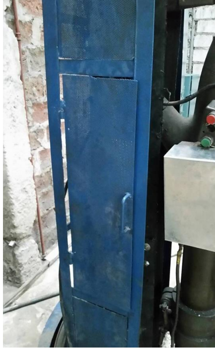
FIGURA 33. GUARDAS LATERALES PARA PROTECCIÓN DE BANDA DE TALADRO DE PEDESTAL.
