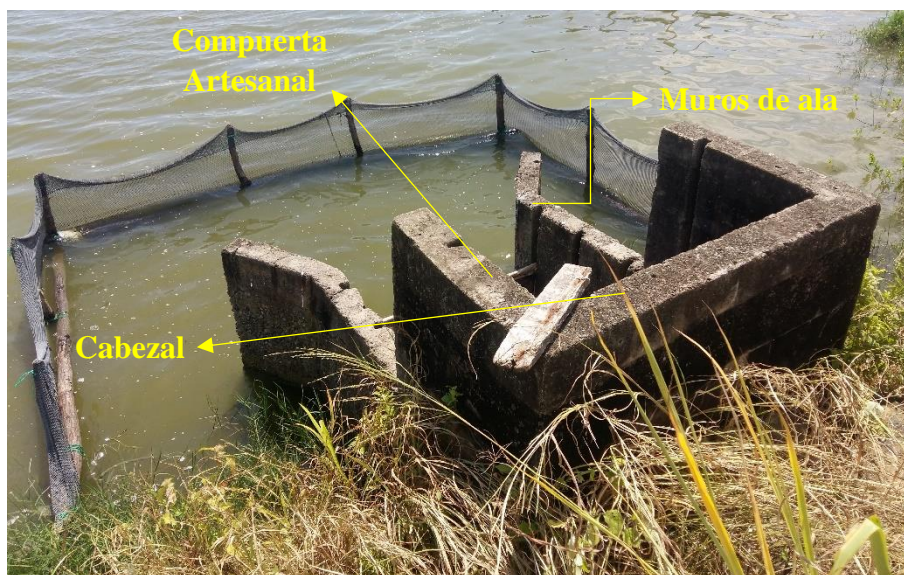
Figura 5.1 Alcantarilla compuerta en piscinas camaronera.
