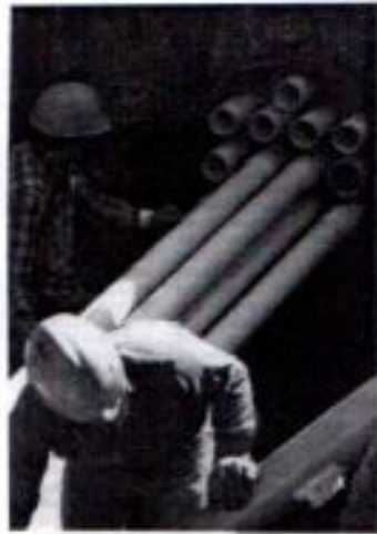
Fig. 4.17: Conductos para cables
