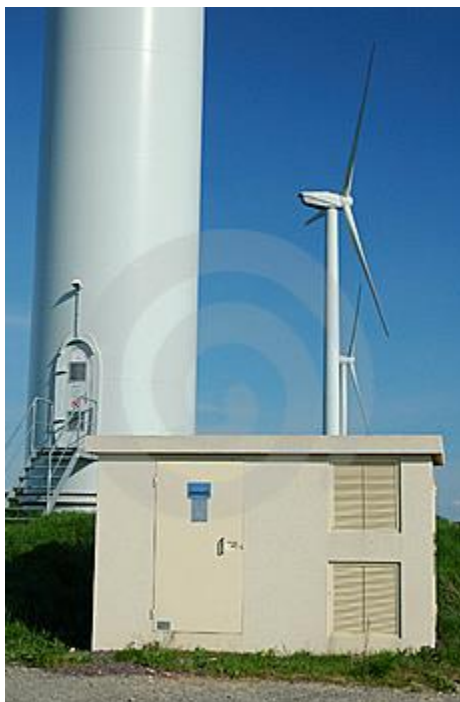
Figura 2.12 Transformador instalado fuera de la torre de un aerogenerador
