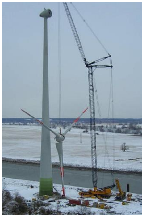
Figura 2.11 Instalación de una turbina Enercon. El empleo de grúas especiales es imprescindible.
