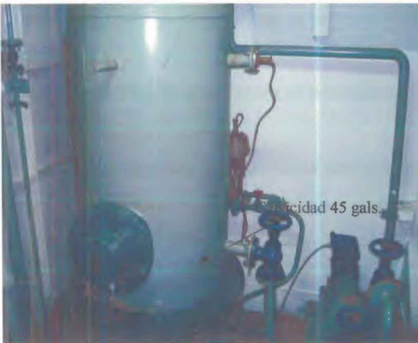
FOTO 24.- Tanque de presión para agua caliente
