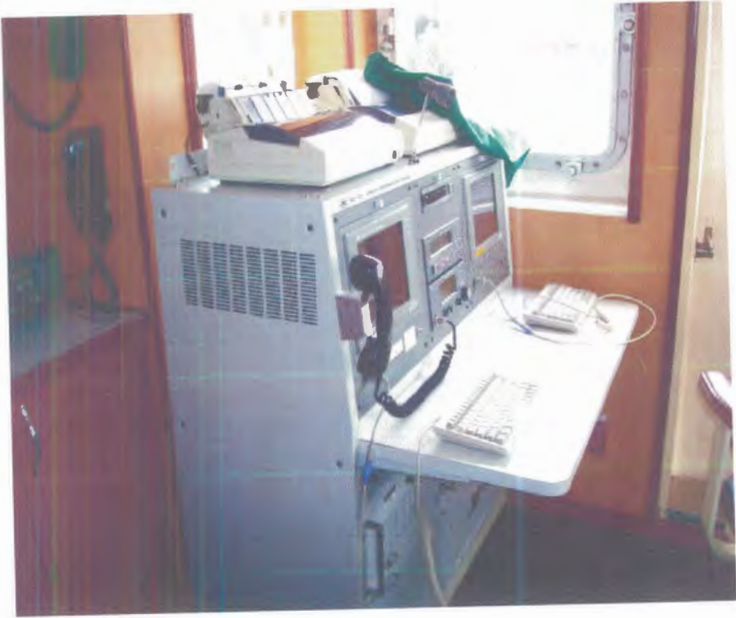
FOTO 20.- Sistema GMDSS con 500 Kg. de peso, instalado en el puente de gobierno
