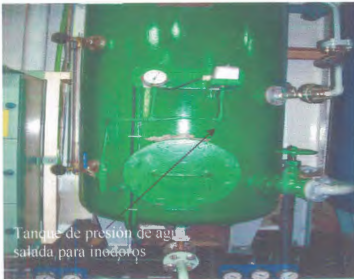
FOTO 26.- Tanque de presión para abastecer de agua salada a los inodoros.
