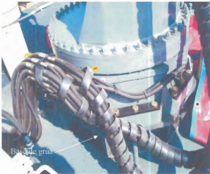
FOTO 30.- Base de la grúa montada en cubierta de popa
