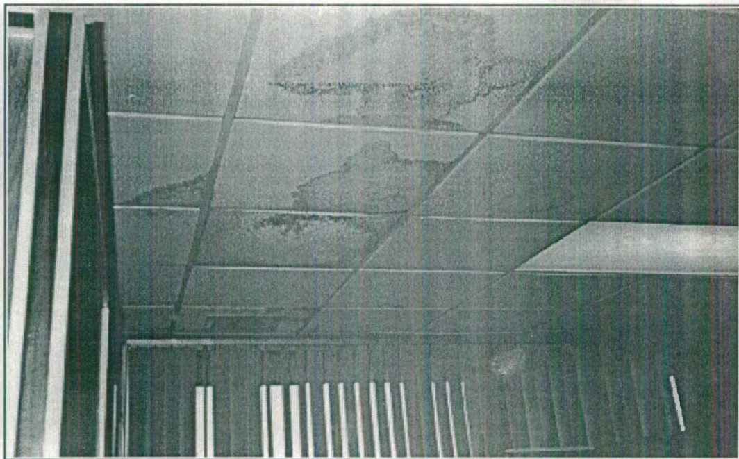
FOTO # 16: Estado del tumbado falso - pándeo y podredumbre - en sector de oficinas de zona de Apoyo Administrativo.
