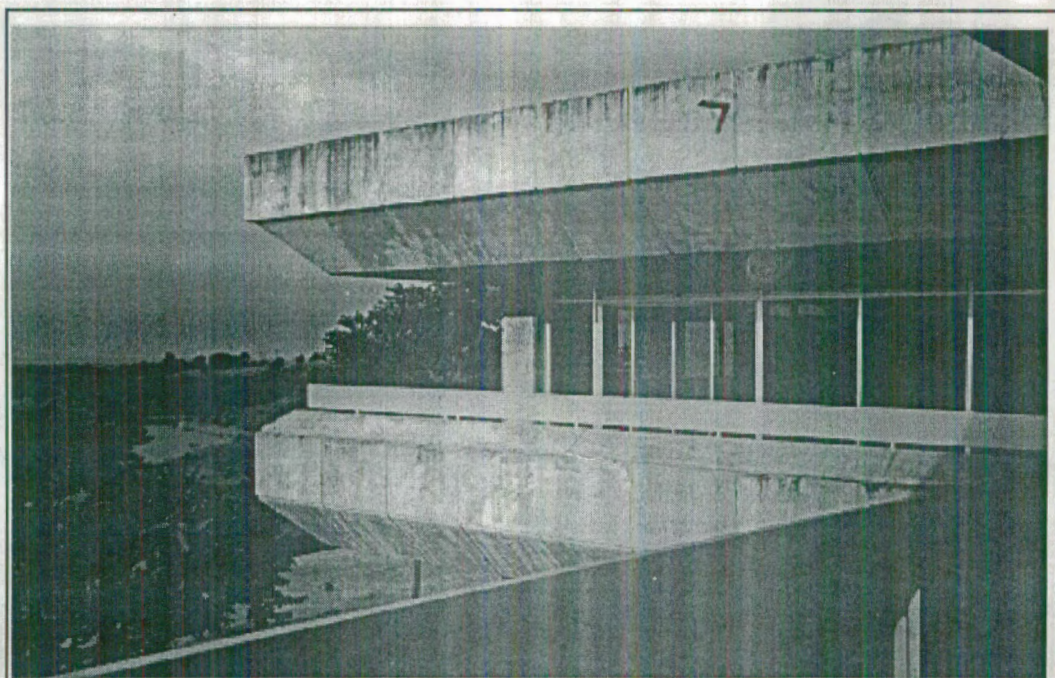
FOTO # 3: Estado de recubrimiento de hormigón visto en fachada lateral de sector principal.
