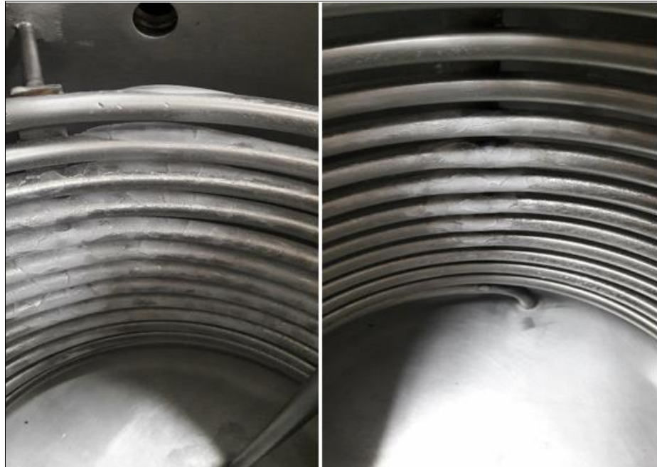
Figura 3.14 Inspección formación de hielo en el serpentín de la trampa de Frío
