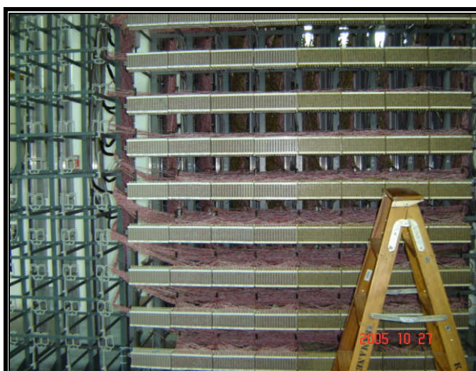
Figura 3.5 Repartidor de la central telefónica Samanes
