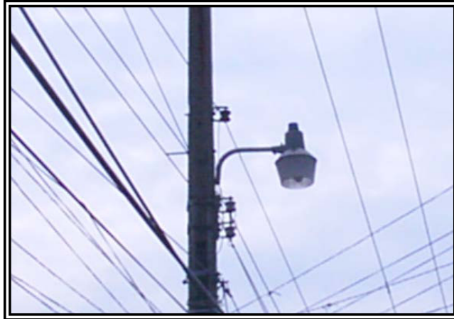
FIG 3.2 Fotografía de una luminaria Tipo Cuadroliner de Mercurio
