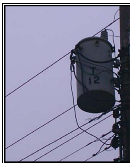
FIG 3.12 Fotografía del transformador T-12 que alimenta Sección AV. PRINCIPAL
