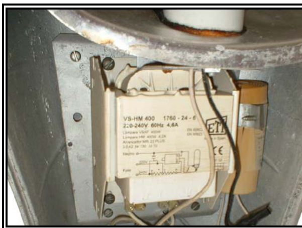
FIG 3.5 Balastro de una lámpara de 400 W
