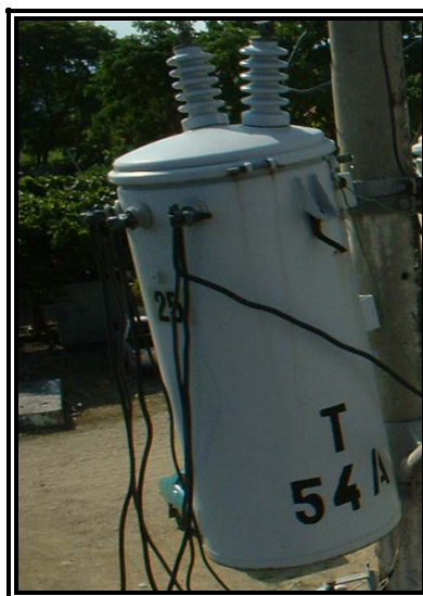
FIG 3.11 Fotografía del transformador T-54 que alimenta Sección DIGMAT
