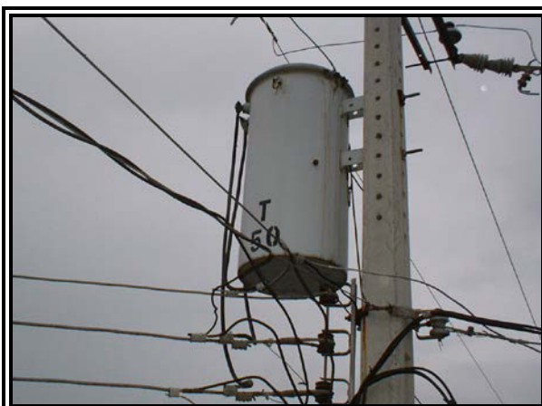
FIG 3.9 Fotografía del transformador T-50 que alimenta Sección HOSNAV
