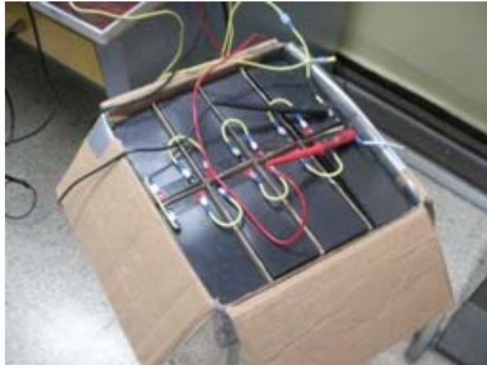
Foto K.7 Banco de Baterías (8 x 12V)
