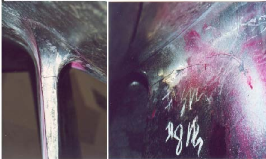
Figura 3.7 Fisuras en rodete turbina Francis.
