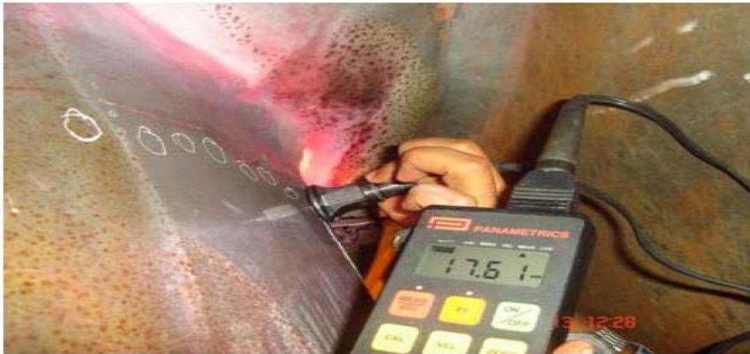
Figura 3.8 Inspección del equipo mediante ultrasonido
