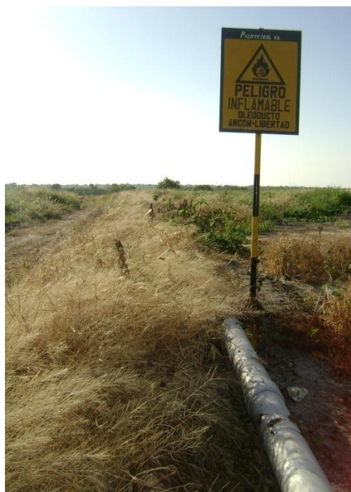
Fig. 2.9 Tuberías de transferencia de petróleo a la refinería de La Libertad
