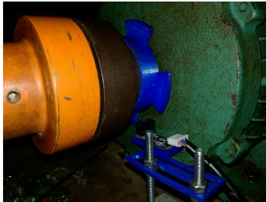
Figura 3.5. Sensor instalado para el conteo de pulsos.
