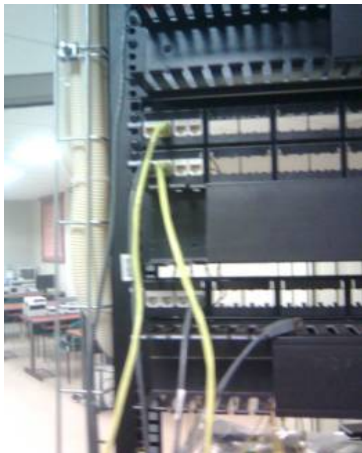
Figura 5.7 Conexión en los puertos del rack
