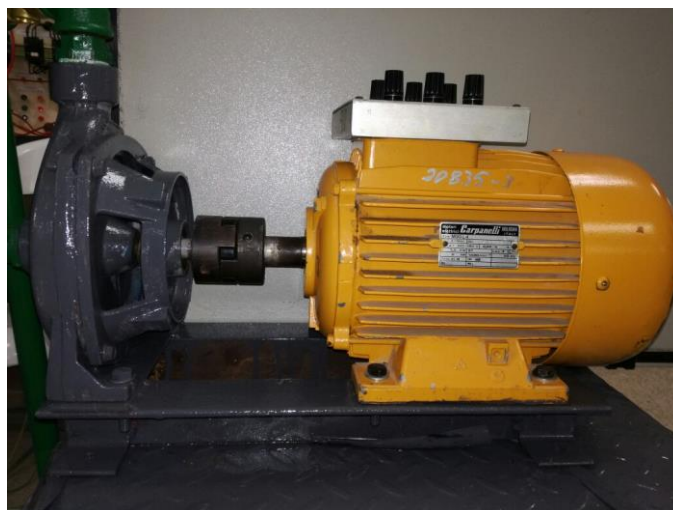
Figura 4.1: Acoplamiento entre motor y bomba centrífuga
