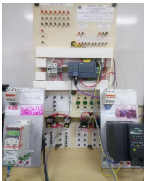
Figura 4.5: Tablero de Control y Fuerza del PLC S7-1200
