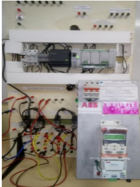
Figura 4.6: Tablero de Control y Fuerza del PLC micrologix 850
