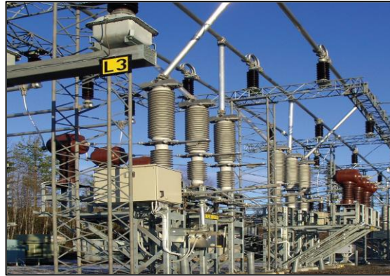
Figura 1. 5 Interruptores para distribución de 72 KV [4]
