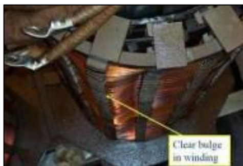
Figura 1. 4 Deformación de una bobina de un transformador [3]
