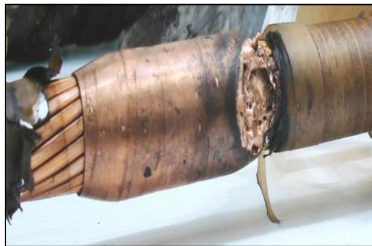
Figura 1. 6 Cable subterráneo quemado debido a falla en su aislamiento
