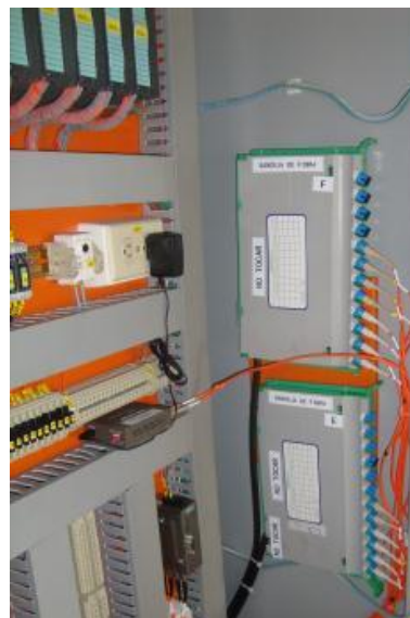
Figura 3.3: Bandejas de Fibra Óptica instalada en tablero de control central
