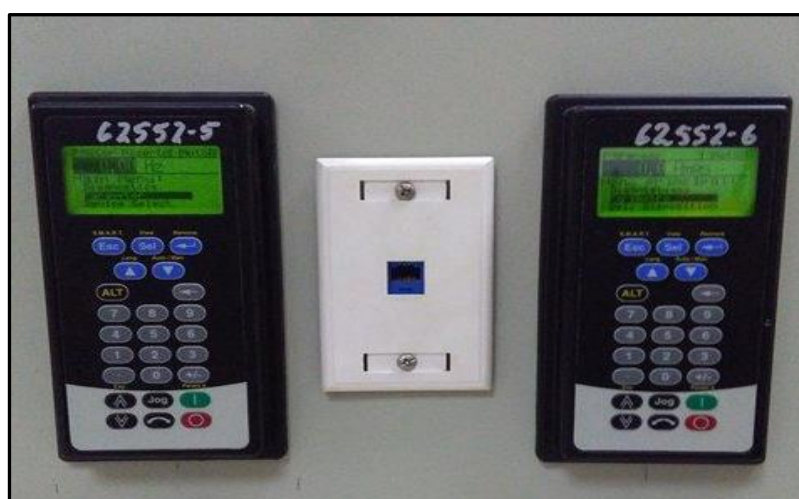
Figura 3. 4 HMI energizadas del Tablero
