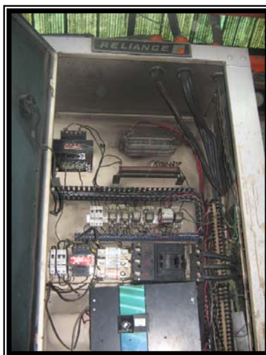
FIGURA. 1.1. Tablero Eléctrico que comanda un motor de C.C. FUENTE: Industria Cartonera Ecuatoriana.
