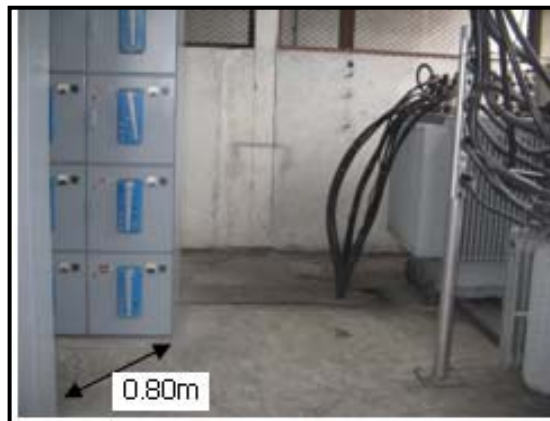
FIGURA # 5.5. Ubicación de los tableros eléctricos. FUENTE: Industria Cartonera Ecuatoriana
