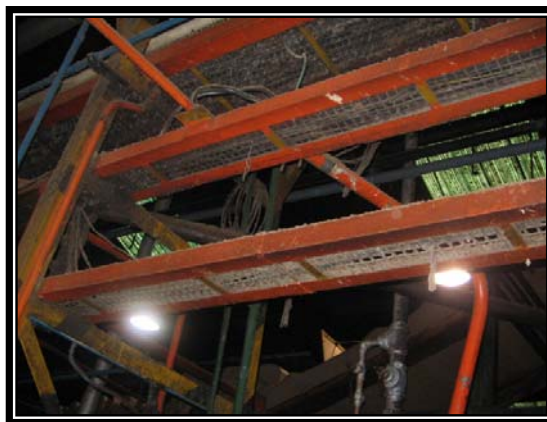
FIGURA 1.11. Canalización con polvo sobre los conductores eléctricos. FUENTE: Industria Cartonera Ecuatoriana.(ICE)
