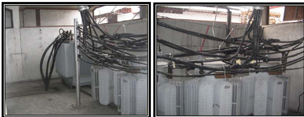
FIGURA # 5.1. Banco de transformadores monofásico y transformador trifásico. FUENTE: Industria Cartonera Ecuatoriana
