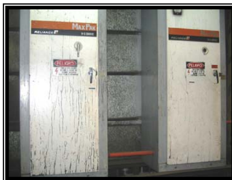
FIGURA 1.4. Tableros de fuerza de la Línea Langston tipo pared y de frente muerto. FUENTE: Industria Cartonera Ecuatoriana.
