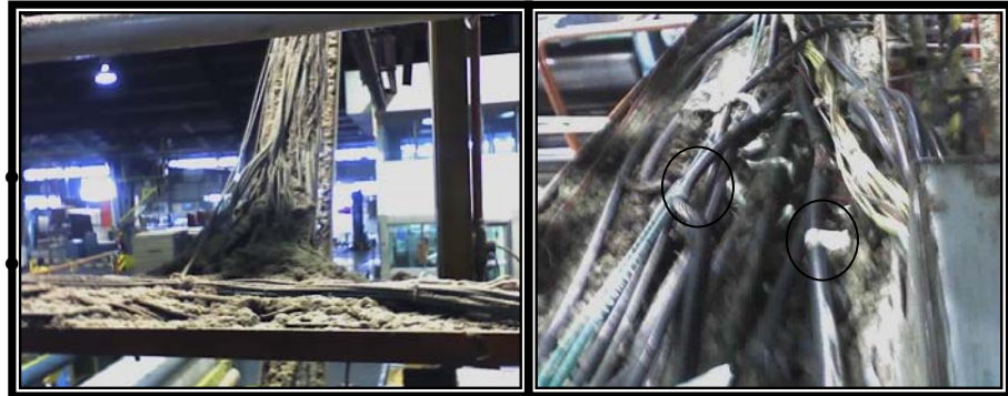
FIGURA #5.3. Conductores y canalizaciones que contienen polvo sobre ellos. FUENTE: Industria Cartonera Ecuatoriana
