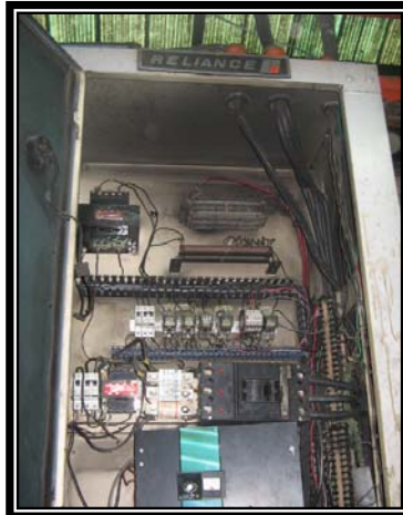
FIGURA # 5.2. Tablero eléctrico de la flauta B. FUENTE: Industria Cartonera Ecuatoriana
