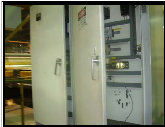
FIGURA 1.3. Tableros de control de la Línea Langston. FUENTE: Industria Cartonera Ecuatoriana
