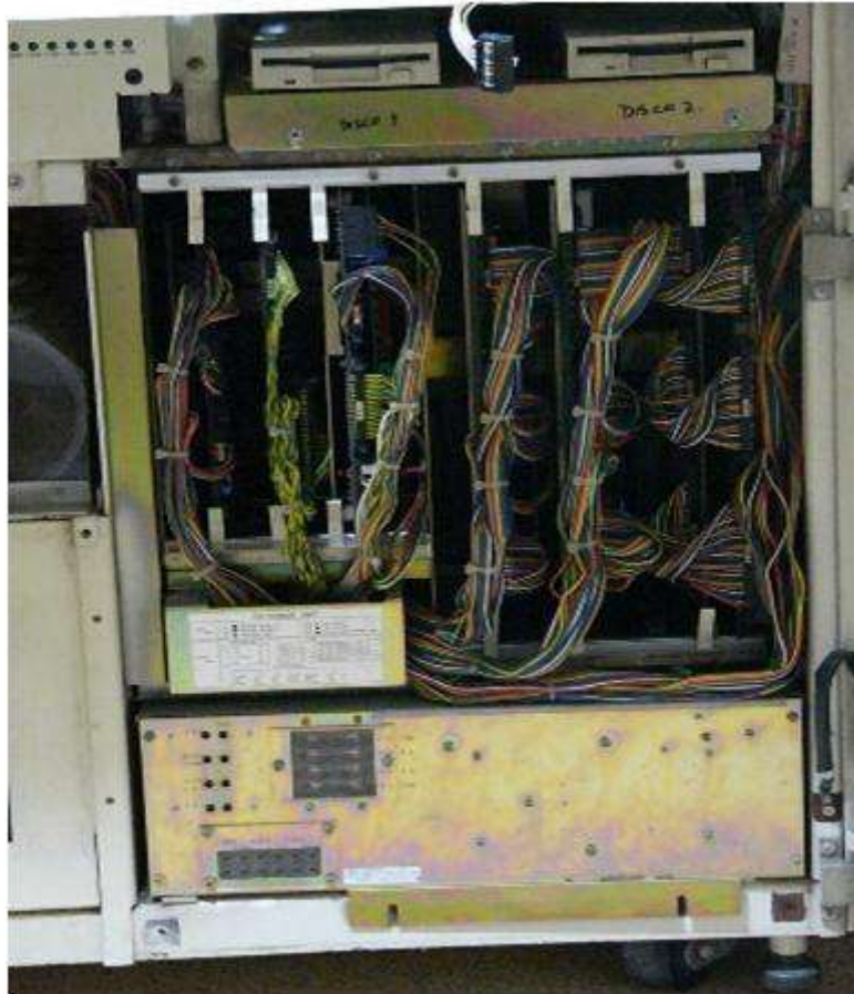
Fig.3.8.Cableado totalmente nuevo y bien estructurado.
