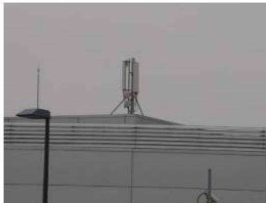
FIGURA 3-6 ANTENA EN MÁSTIL
