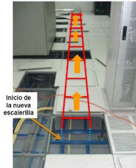
FIGURA 4-11 CABLE DE ENERGIA RECORRIDO HORIZONTAL (2)
