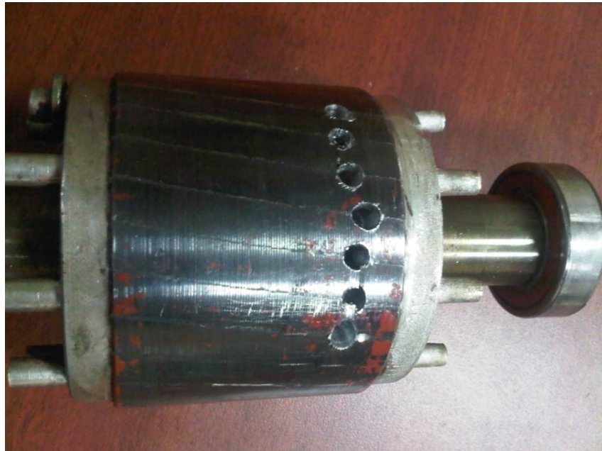
Figura 4.50 Rotura de 7 barras en el rotor
