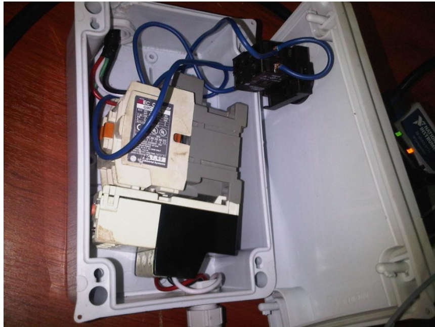
Figura 3.3 Contactor, relé térmico y pulsador con luz piloto utilizado en las pruebas
