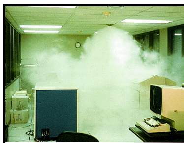
Figura 2.13 Gas Protección contra Incendios
