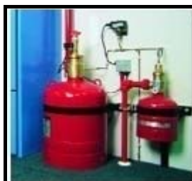
Figura 3.15 FM-200 – Protección Incendios
