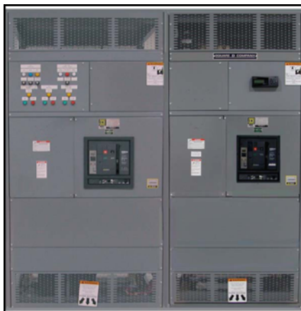
Figura 2.4 Switch de Transferencia Automática (ATS-NW Clase 2700)
