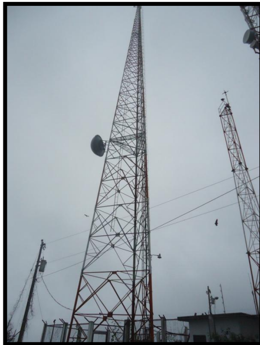
Figura 5.19 Antena de la Repetidora - Olón
