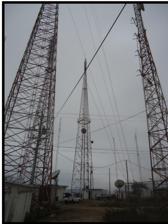
Figura 5.21 Antena Transmisor – Santa Elena
