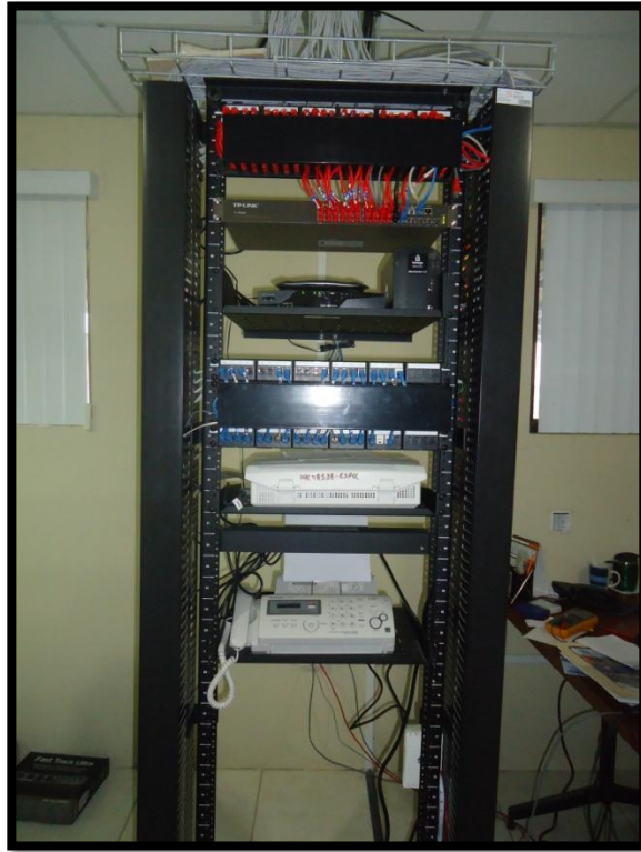
Figura 5.14 Rack para dar internet al canal
