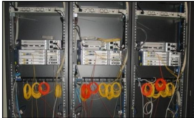
Figura 2.2.- Equipos HUAWEI OPTIX OSN1500 [9]
