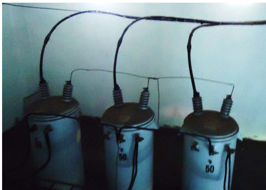
Figura 2.5. Transformador de alimentación del área de laboratorio clínico del hospital Valenzuela.
