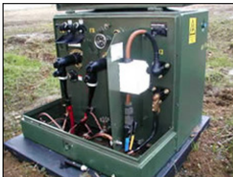
Figura 4.1. Transformador de distribución eléctrica.
