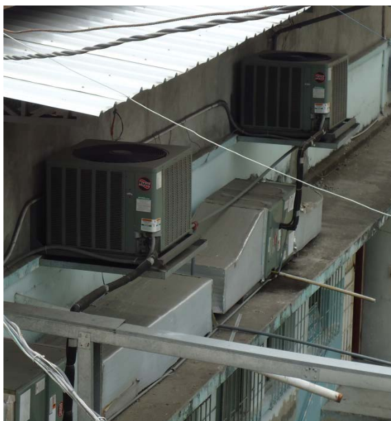
Figura 4.2. Unidades de climatización.
