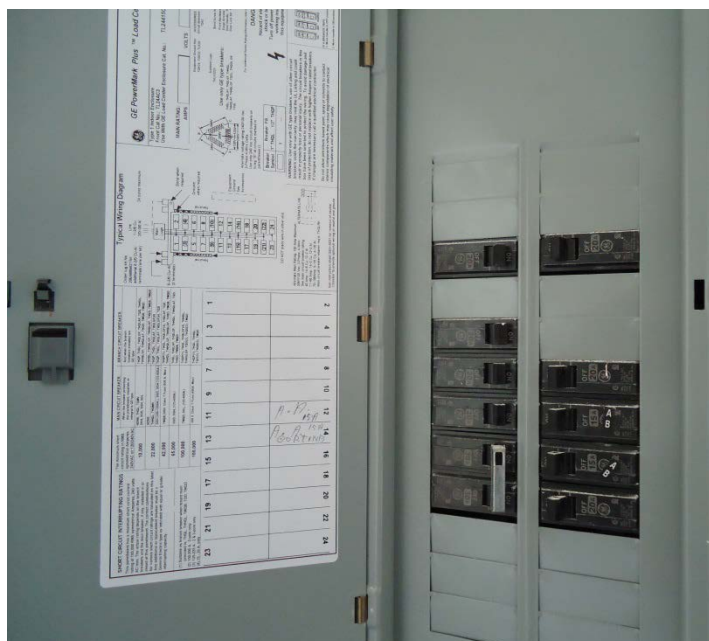
Figura3.1. Panel de disyuntores del laboratorio del hospital Valenzuela.
