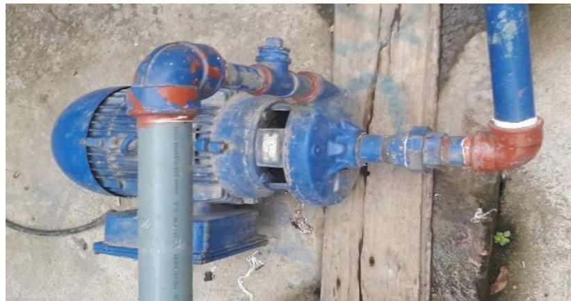
Figura 4. 13 Bomba Mark DS-9 utilizada en PTAP Juan Bautista Fuente: González, M., Pinargote, D., 2018.
