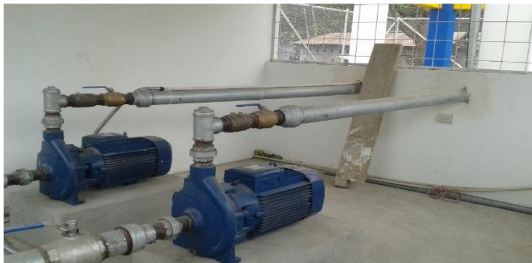
Figura 4. 16 Bombas Pedrollo en paralelo– Estación “Los Amarillos” Fuente: González, M., Pinargote, D., 2018
