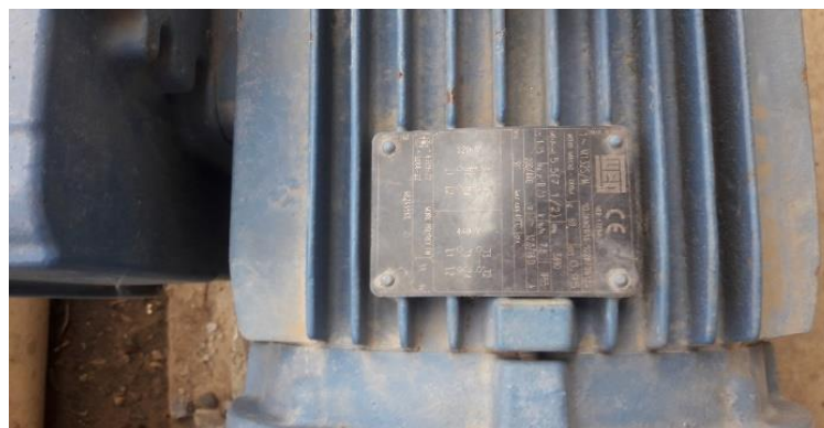
Figura 4. 14 Placa descriptiva motor WEG de la bomba Mark DS-9 Fuente: González, M., Pinargote, D., 2018.
