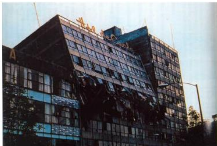
Figura 3.8 Golpeteo entre edificios en México. Fuente: Serrano.R, 2001.
