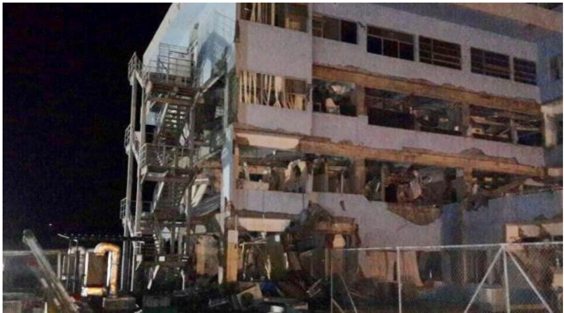
Figura 1.1 Hospital del IEES de Manta luego del terremoto del 2016.
