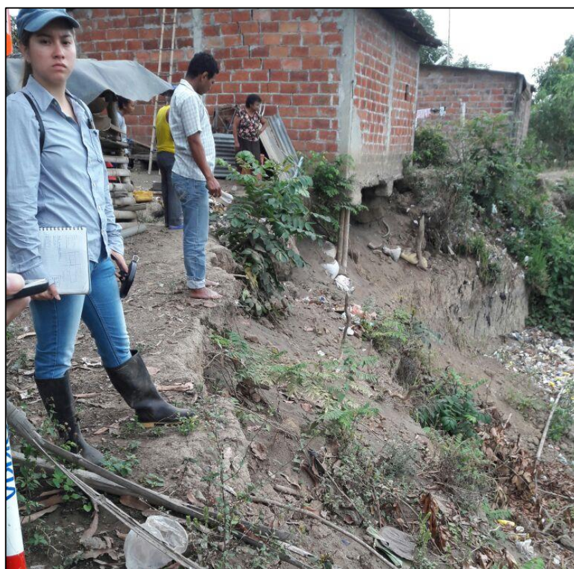
Figura 2.6 Vivienda afectada por la erosión del margen del cauce.
