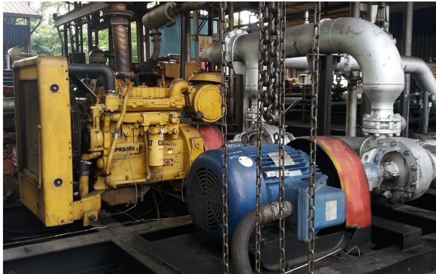
Figura 1.17 bombas booster Fuente: (Choca-Quisnancela, 2018)
