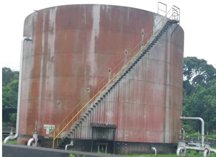
Figura 1.11 Tanque de surgencia usado como tanque de lavado Fuente: (Choca-Quisnancela, 2018)
