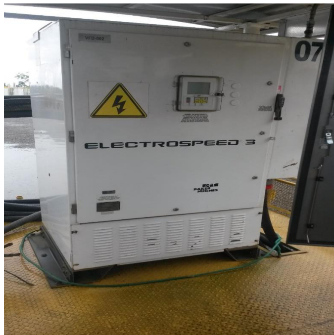
Figura 1.28 Variador (VFD) Fuente: (Choca-Quinancela, 2018)
