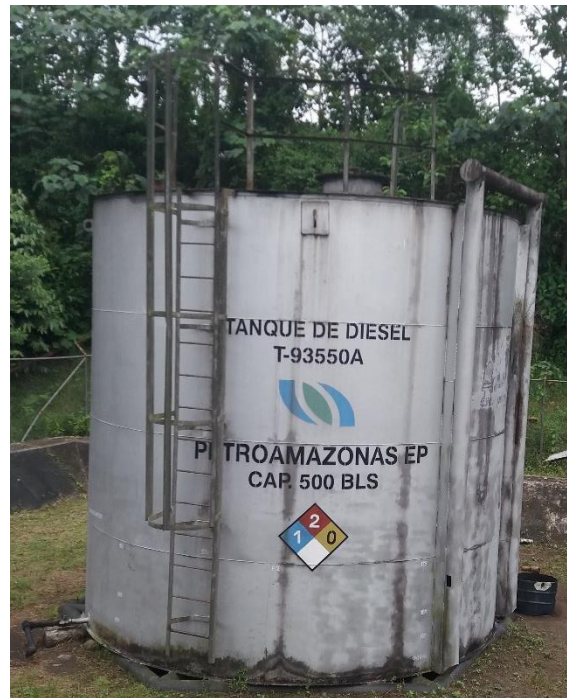
Figura 1.23 Tanque de almacenamiento de diésel Fuente: (Choca-Quisnancela, 2018)
