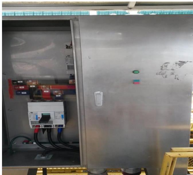
Figura 1.29 Distribuidor de energía eléctrica Fuente: (Choca-Quinancela, 2018)
