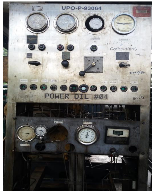
Figura 1.20 tablero de control Fuente: (Choca-Quisnancela, 2018)
