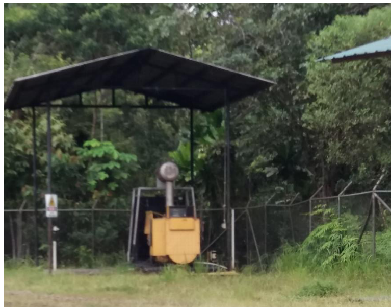
Figura 1.16 Generador eléctrico del campo Pucuna Fuente: (Choca-Quinancela, 2018)
