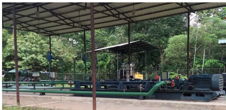
Figura 1.14 Bombas HPS, parte del sistema de reinyección
