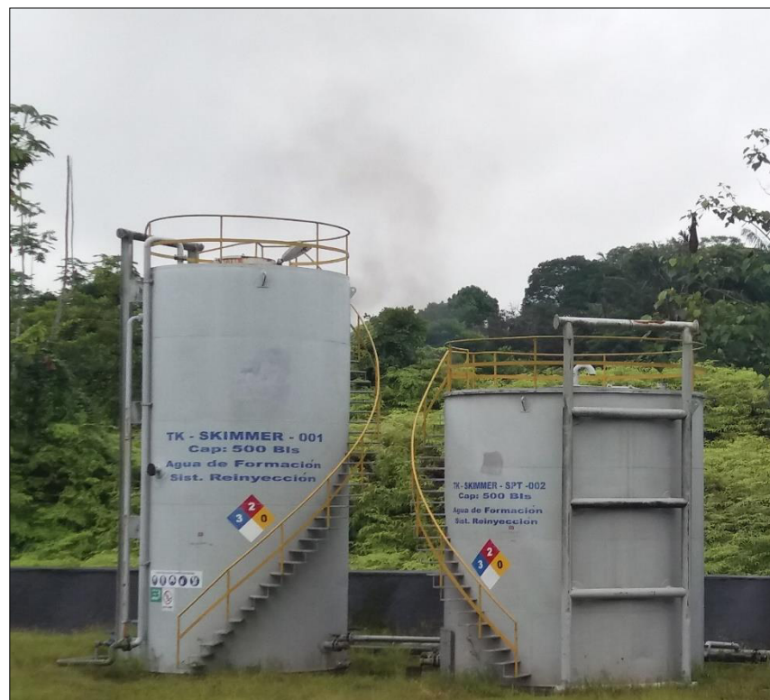
Figura 1.27 Tanques de reinyección de agua de formación Fuente: (Choca-Quinancela, 2018)
