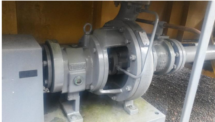
Figura 1.30 Bomba Booster . Fuente: (Choca-Quinancela, 2018)
