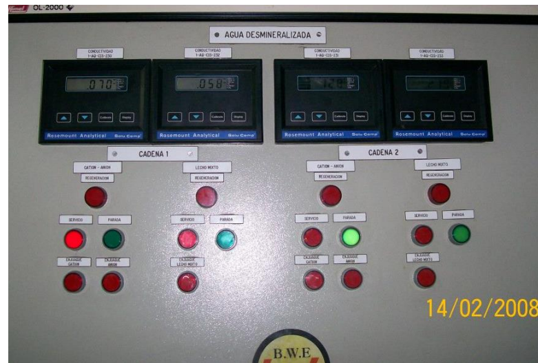
Figura No 1. Panel de control, proceso de desmineralización.
