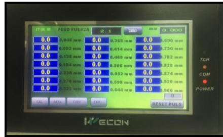
Figura 3.3 Ventana principal de la pantalla HMI
