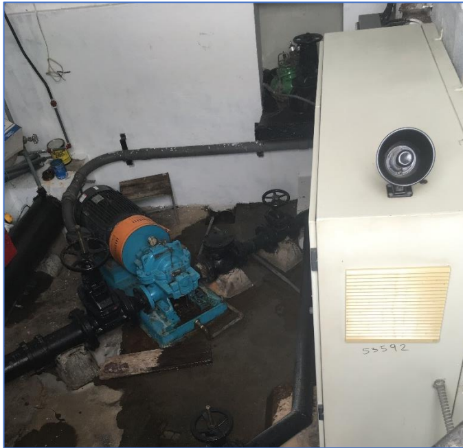
Figura 4.4: Cuarto de sistema de bombas.
