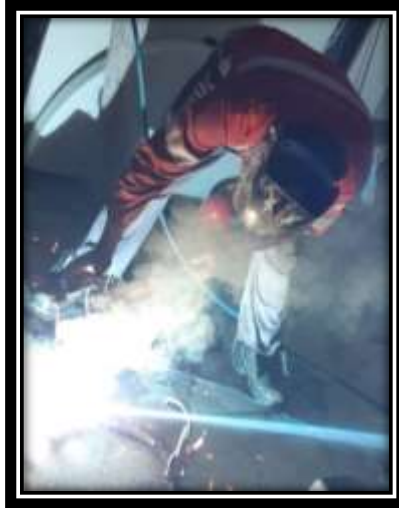
Figura 1.9 Humo producido por la soldadura.
