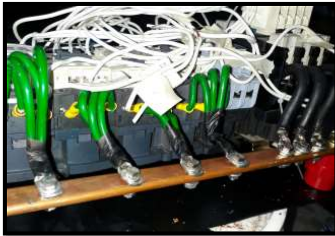
Figura 3.5 Conexión de los contactores a la barra de cobre.
