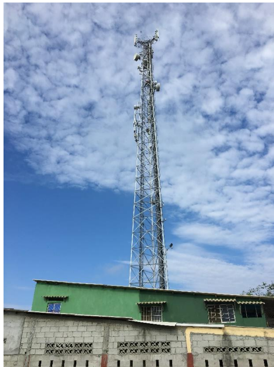
Anexo 4 Torre de servicios de telecomunicaciones, ubicación de equipos de nodo central
