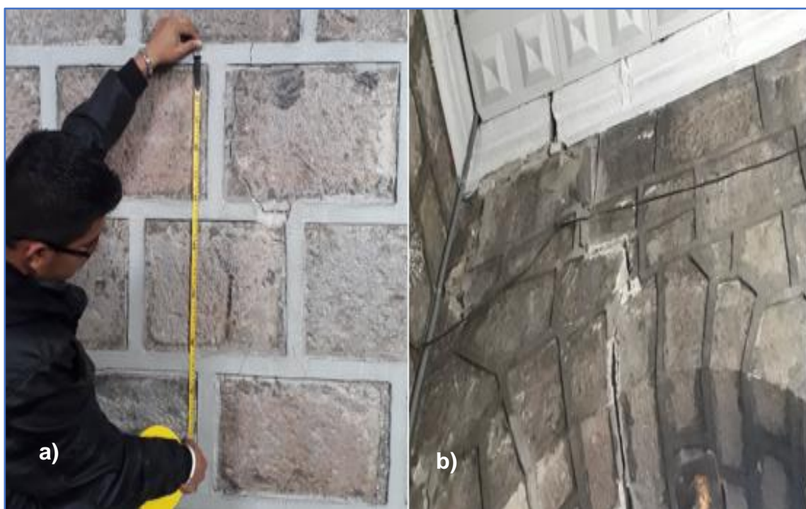
Figura 2.2 Medición de fisuras en la iglesia.
