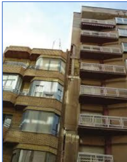
Figura 1.4 Golpeteo en edificios.
