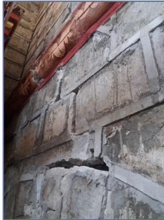
Figura 3.18 Grietas de apertura de 5cm cerca del altar.
