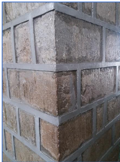
Figura 2.12 Mortero observado durante la inspección a la estructura.
