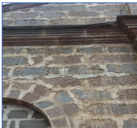
Figura 1.5 Fisuras presente en la argamasa.
