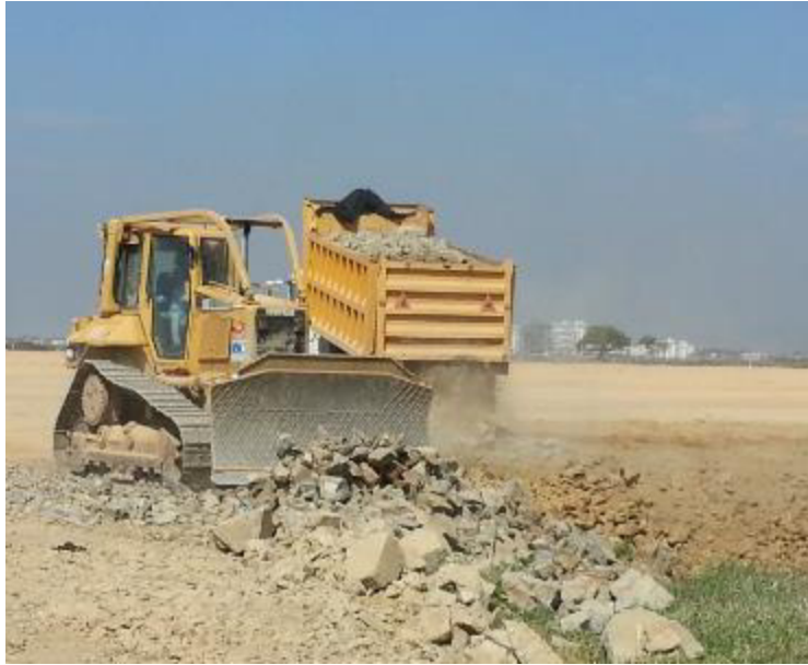
Figura 33. Descarga de material grueso (piedra gruesa) primera capa, en zonas húmedas y blandas. Fuente Elaboración Autor
