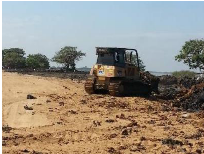
Figura 32. Tractor D6, apilando la capa vegetal del área de trabajo, para luego ser retirada Fuente Elaboración Autor
