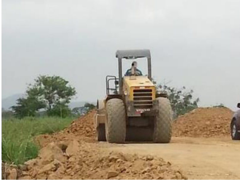
Figura 39. Compactación de terreno en capas de 0,40 m., altura; previa hidratación. Fuente Elaboración Autor
