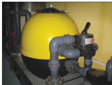
Figura 1.4.- Filtro de arena presurizado para un sistema de depuración. (Lee & Ababouch, 2010).
