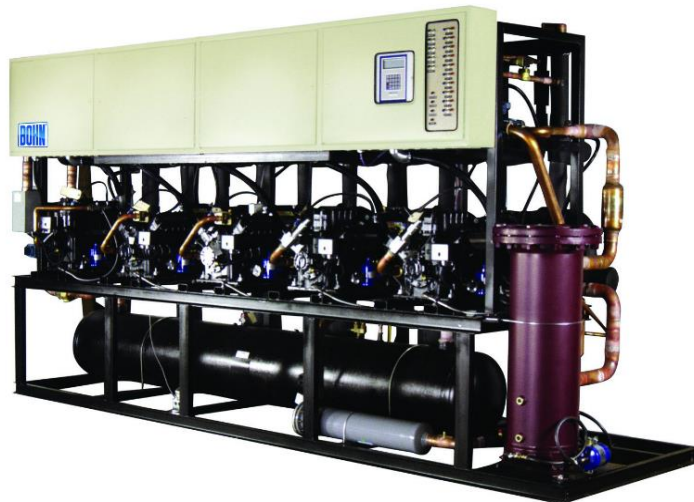
Figura 2.4: Rack de compresores [www.cuartosfrios.com]
