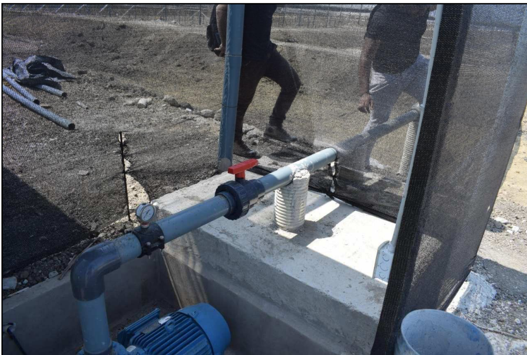
Ilustración 6. 4 Revisión del sistema de alimentación de agua para piscinas de engorde. Fuente: Propia del autor.
