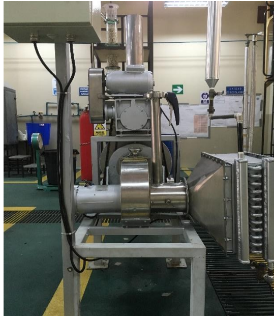
Figura N.- 15 Instalación del secador rotatorio
