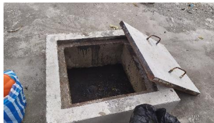
Figura 2.2. Reactor anaeróbico de la PTAR
