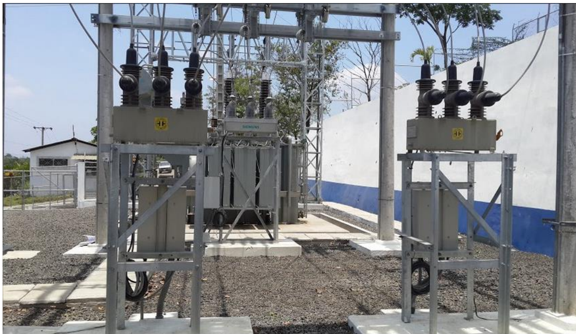
Figura 3.4 Transformador de 10/12,5 MVA
