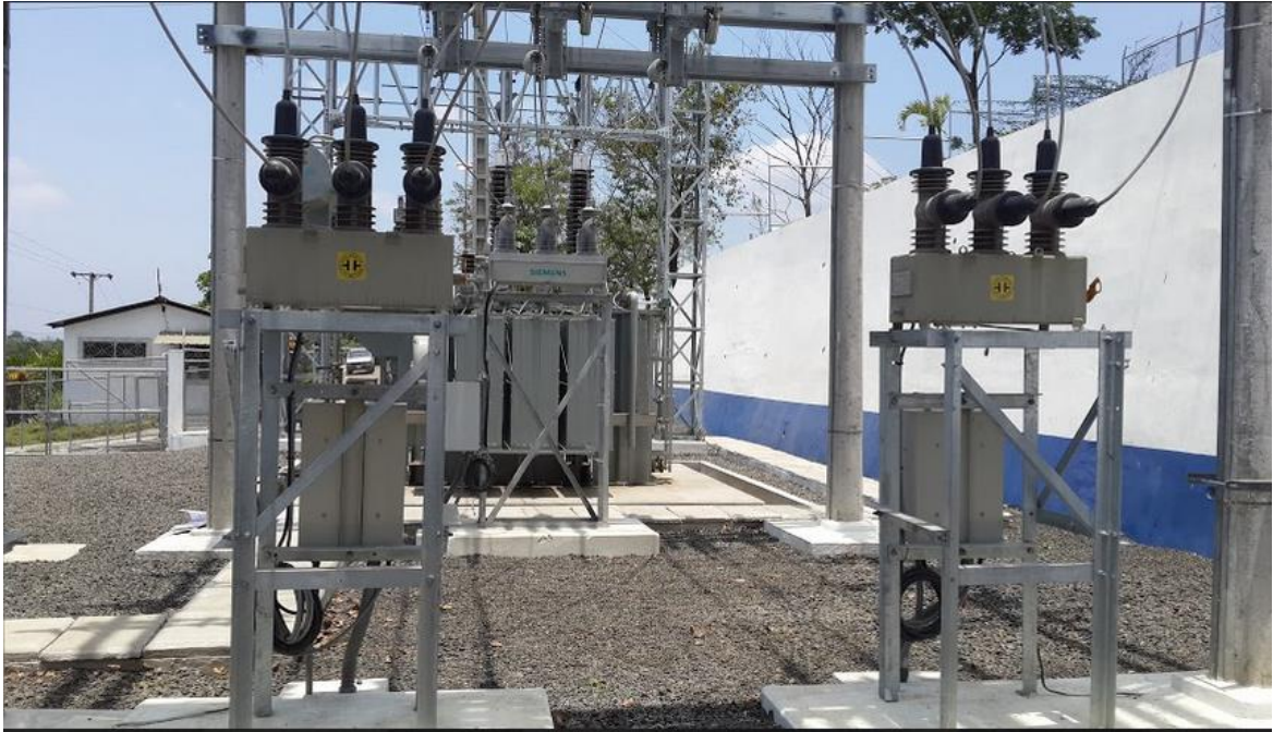
Gráfica N°4.- Foto en primer plano de la subestación.
