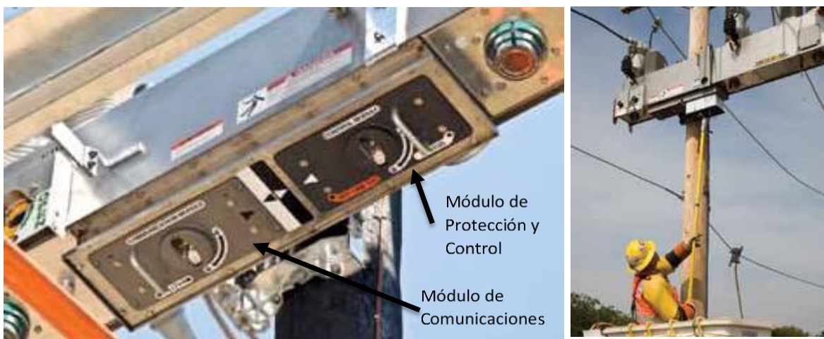
Figura 2.12 Módulos de control y comunicaciones de un intellirupter [11]
