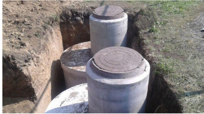
Figura 2.11: Pozo de inspección. Fuente: Decorexpro
