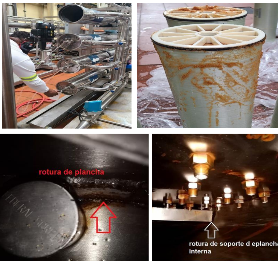
Figura 2. 23 Cartuchos con migración de resina y tanque con fisuras.
