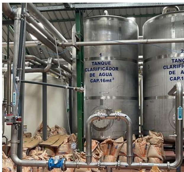
Figura 2. 33 Planta de agua sin tanque ablandador
