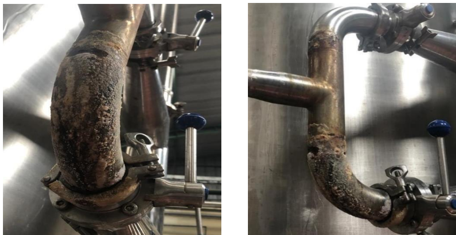
Figura 2. 10 Tubería con incrustaciones.
