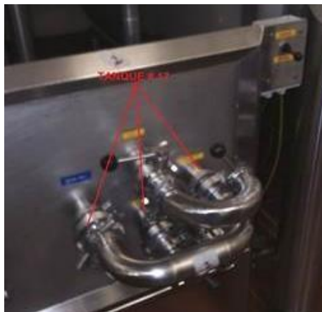
Figura 2. 11 Tuberías en sala de jarabe antes de la mejora.
